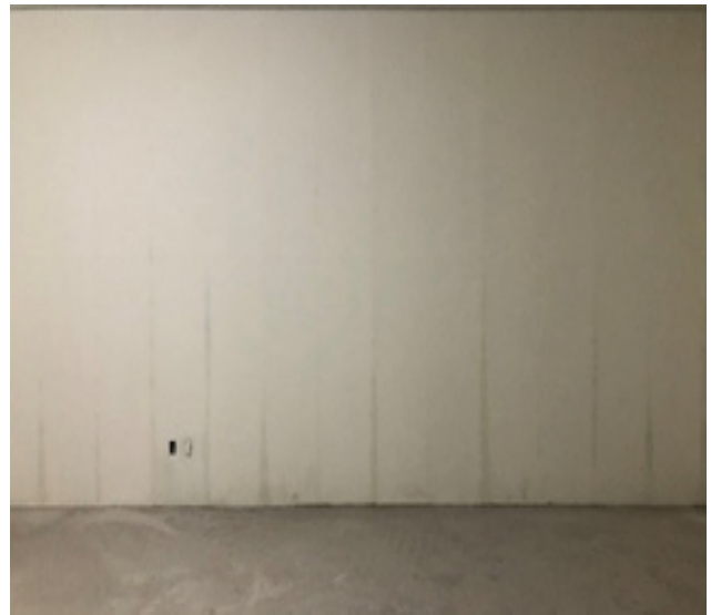
석고보드 표면 C-스터드 부위 마감 이색 사례
