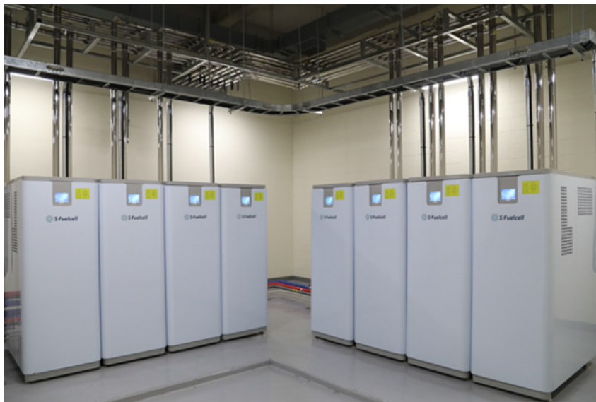
연료전지 설치 사례(엘지트윈타워, 용량 48kW)
