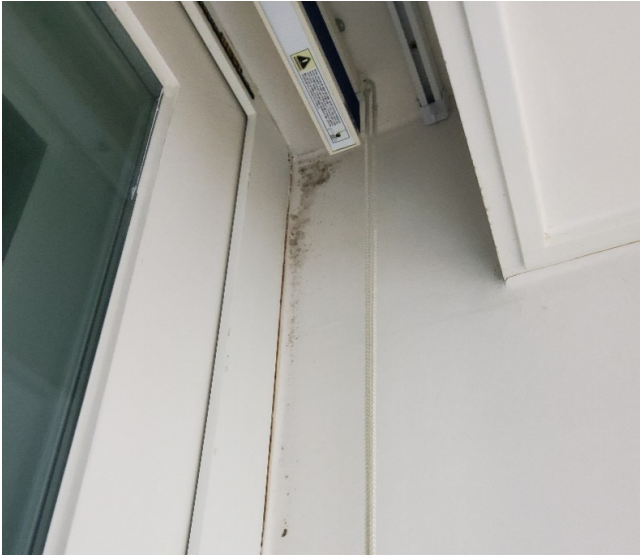
벽체 우각부 및 모서리 곰팡이 발생 사례
