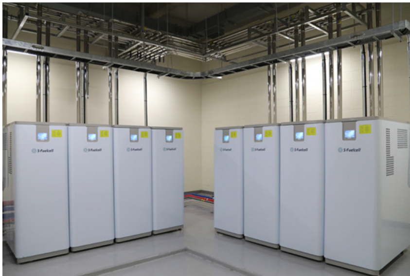
연료전지 설치 사례(엘지트윈타워, 용량 48kW)
