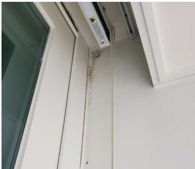
벽체 우각부 및 모서리 곰팡이 발생 사례
